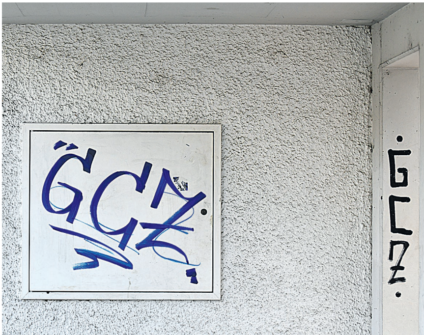
Der Velounterstand in Endingen ist mit etlichen Schriftzügen beschädigt worden.
