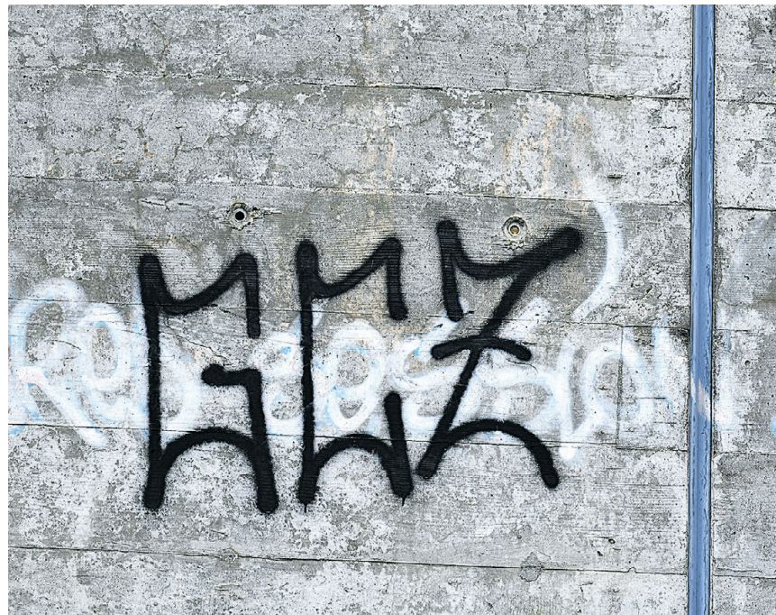
Beim Weg in die Strassenunterführung in Tegerfelden hat die Täterschaft auch nicht haltgemacht.
